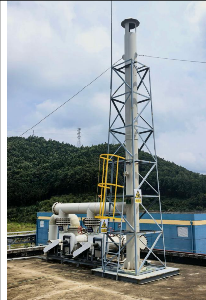
车间尾气排放口 10#
