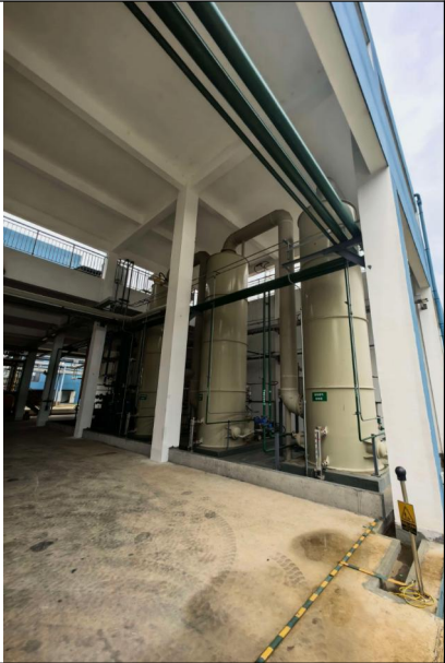
氟化氢铵尾气吸收塔
