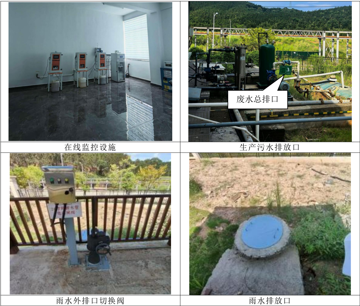
图 4.5-1 排污口、监测设施及在线监测装置现场情况
