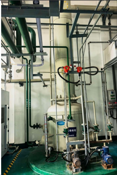
氟化铵溶液尾气吸收塔
